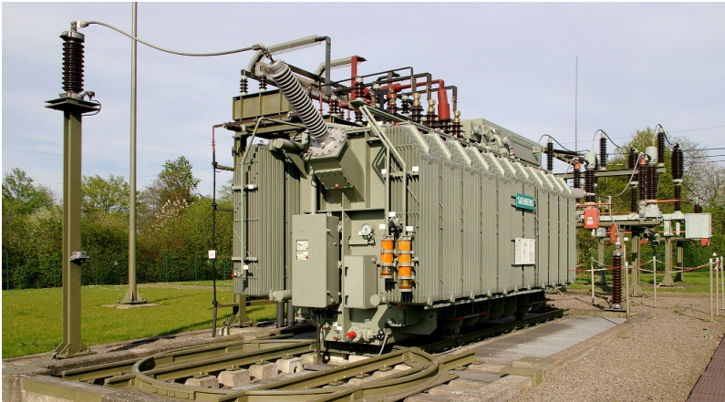
Fig. 189: Transformilo en elektrejo
